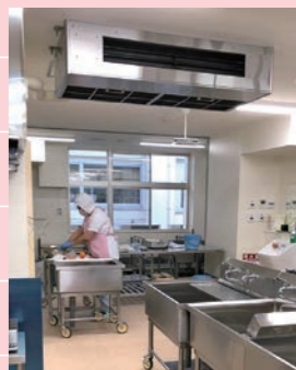
学校給食室のエアコン
